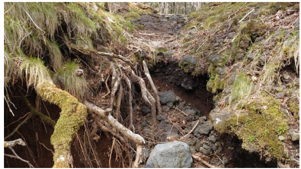
(この段差も歩けたが、石を埋めるなど補修必要)
