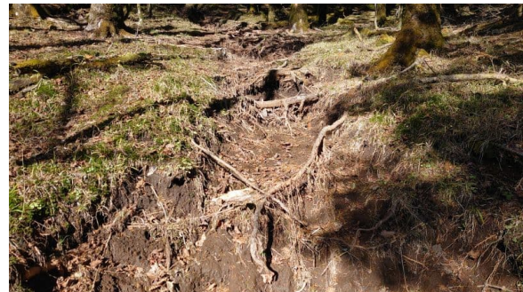
(水ミチ化、樹木根露出・損傷、歩道拡幅)
