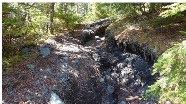
(洗掘した歩道、脇は植生損傷、C1コース)
