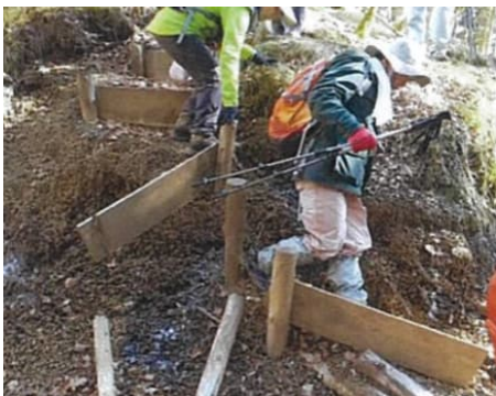
(土留め階段の破損、Bコース)
