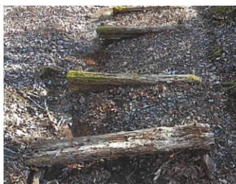
(腐食した丸太階段、Lコース)
