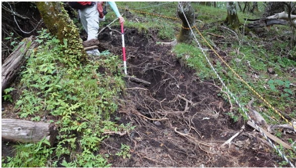
(ミズ道化した歩道の侵食、樹木根が露出)
