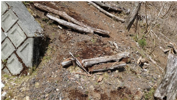
(腐食で滑りやすい丸太階段、黒塚南鉄塔脇)
