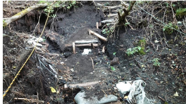
(右側の立杭部分の土台が侵食でなくなり木段流出)
